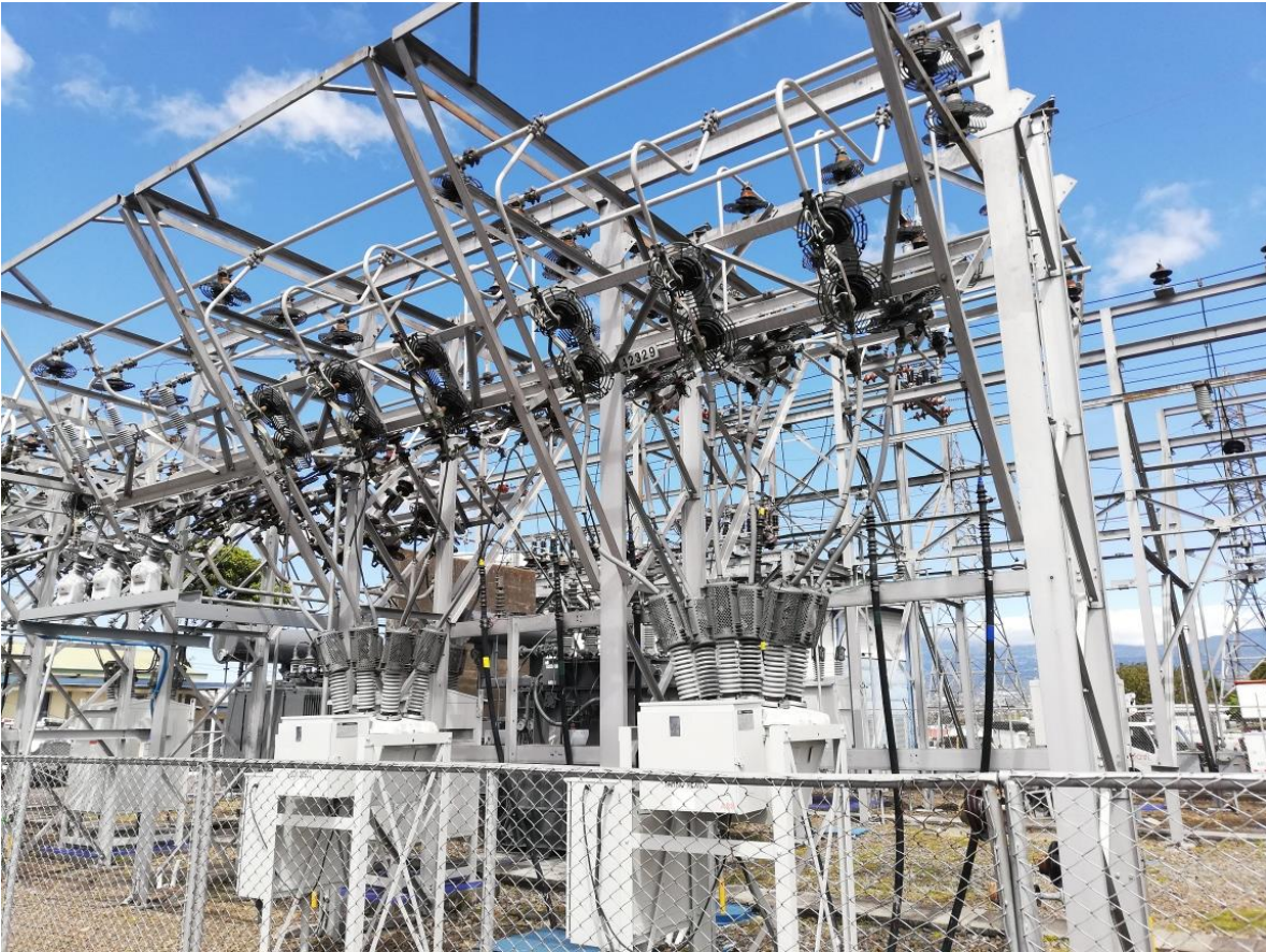
Figura 30 D. Subestación protegida con protectores electrostáticos colocados verticalmente y aisladores. Fuente: ESPH.
