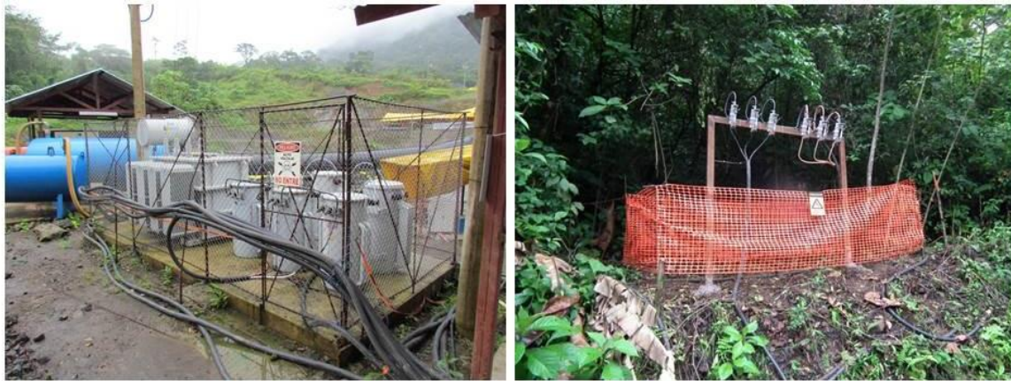
Figura 20. Barreras perimetrales que no contemplan medidas de prevención de electrocución (Fuente: CNFL).
